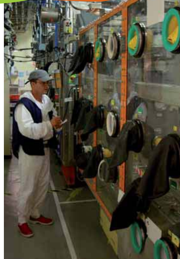
Boîtes à gants de l'installation ATPu où a été découvert le plutonium résiduel. © areva nc
