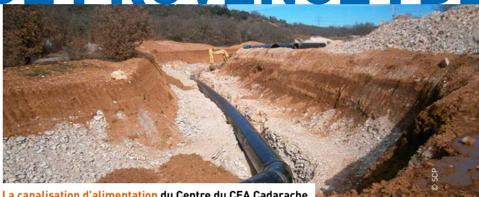
La canalisation d'alimentation du Centre du CEA Cadarache
